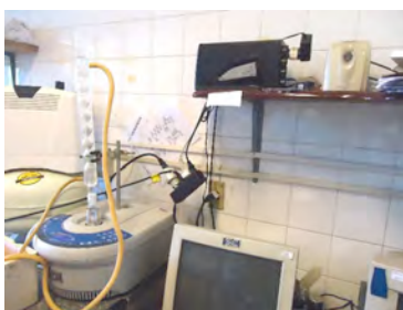
Figura 3 – Improvisação com extensões devido ao aumento de equipamentos
