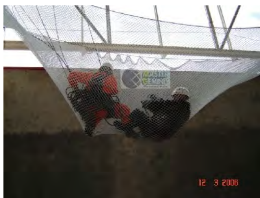
Figura 4 – Utilização do Sistema de Proteção com Redes
