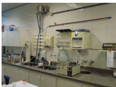
Figura 2 – Bebedouro em local inapropriado no laboratório de patologia
