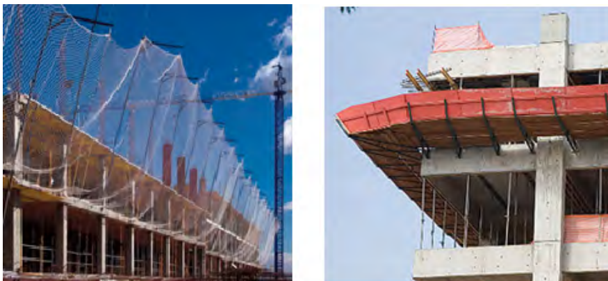
Figura 1 – Sistema de Proteção com Redes e Sistema de Proteção de Bandejas
