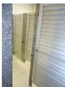
Figura 8 – Falha de acessibilidade na largura da porta do banheiro
