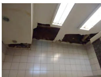
Figura 5 – Forro quebrado no banheiro
