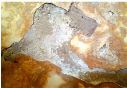
Figura 3 – Descolamento da argamassa do reboco por eflorescência
