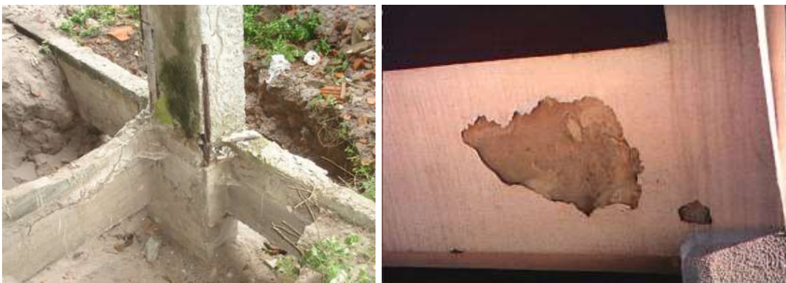
Figuras 1 e 2 – Corrosão da armadura de fundação e descolamento da argamassa .
