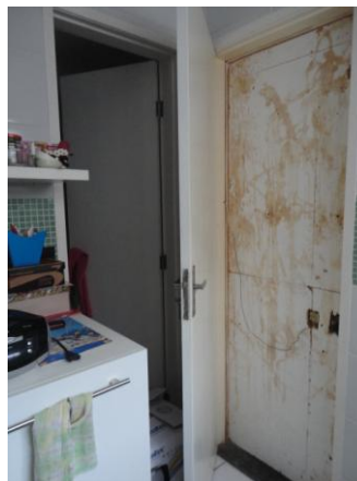
Acesso vedado com madeira
