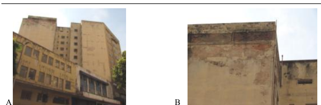
Fachada Nordeste. A. Vista parcial. B. Detalhe da degradação do revestimento. Fonte: Acervo do autor.
