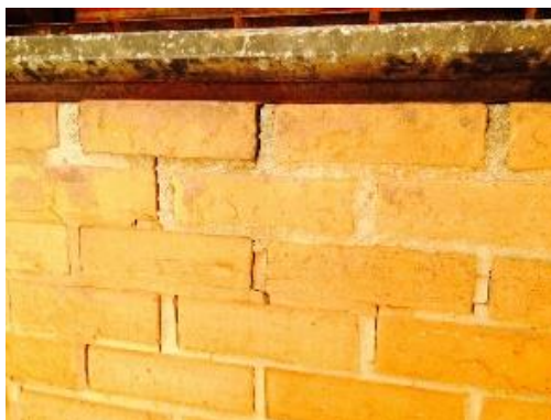
Figura 1 - Fissuração pontual ocorrida, provavelmente, pela não adequação da argamassa de assentamento à variação térmica
