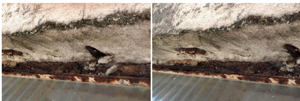
Figura 8: Viga com deslocamento antes e após o ensaio com fenolftaleína (à esquerda e à direita, respectivamente) com a mesma coloração
