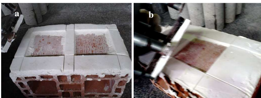
Figura 2 - Aspecto das áreas de arrancamento do revestimento de gesso
