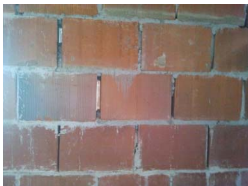
Figura 4 – Alvenaria com juntas verticais sem preenchimento
