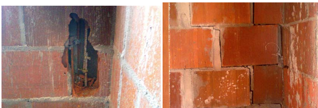
Figura 6 – a) Grauteamento mal executado; b) Fissura na alvenaria; c) Rasgos na alvenaria; d) Bolor em blocos
