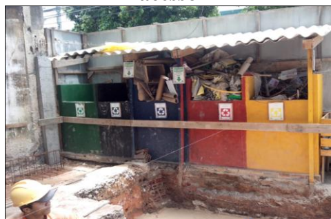
Figura 8 - Baias com dificuldade de acesso
