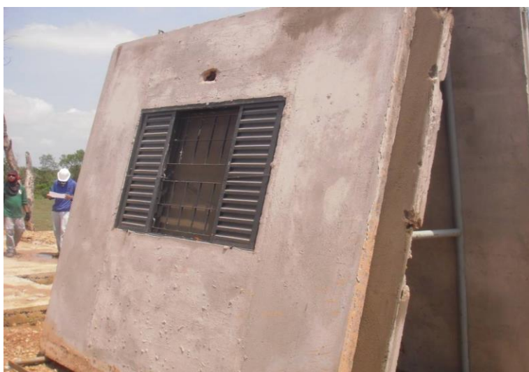
Figura 1 – Presença de algum tipo de fissura na residência
