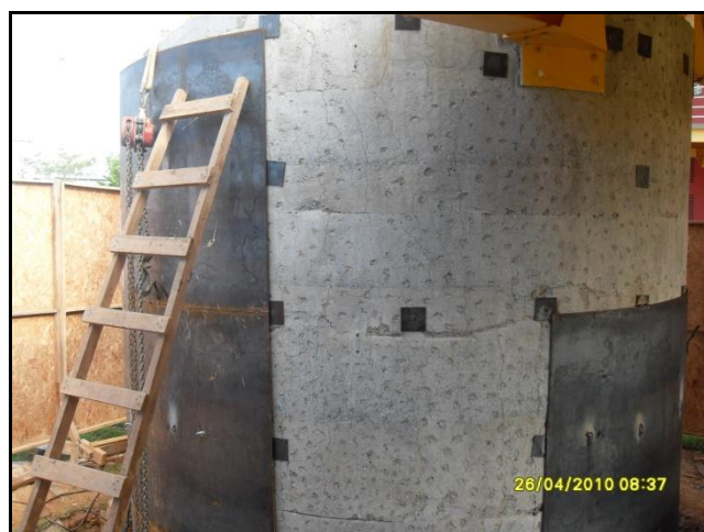
Figura 10 - Pilar em processo de montagem das chapas, após recuperação e esscarificação da superfície para melhor aderência da resina.
