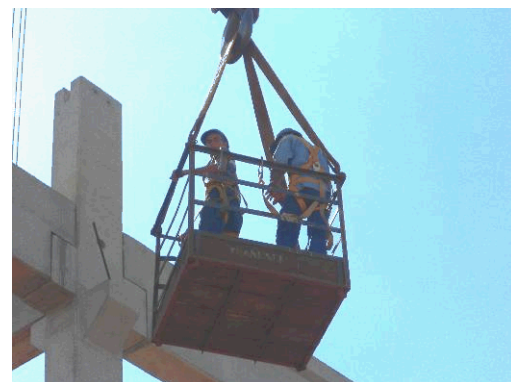
Figura 4 – Operários com uso de cinto de segurança durante o transporte em “gaiola”
