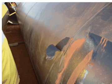
Figura 5 - Foto de tubos com problemas no revestimento
