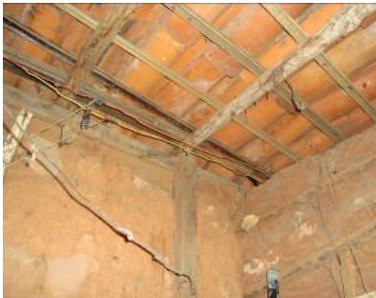
Figura 3 - Madeiramento irregular da cobertura, em madeira cerrada da construção no bairro São João. Foto: Thaís Carvalho (2009)
