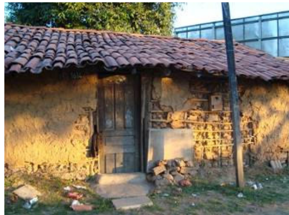
Figura 4 - Paredes externa em péssima conservação da construção no bairro São João. Foto: Thaís Carvalho (2009)
