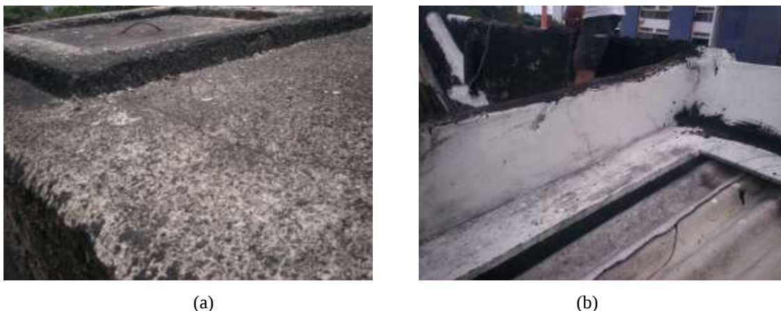
Figura 11- Fissura e fungos na laje do reservatório (a). Fissuras em platibanda e telha quebrada (b)
