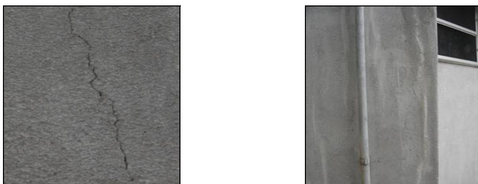
Figura 5 – Fissuras abertas e outras calafetadas no revestimento do edifício 2
