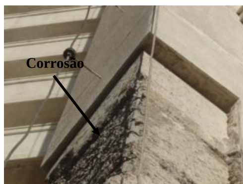
Figura 10 – Diferentes enchimentos e processo de corrosão no pilar do edifício 2
