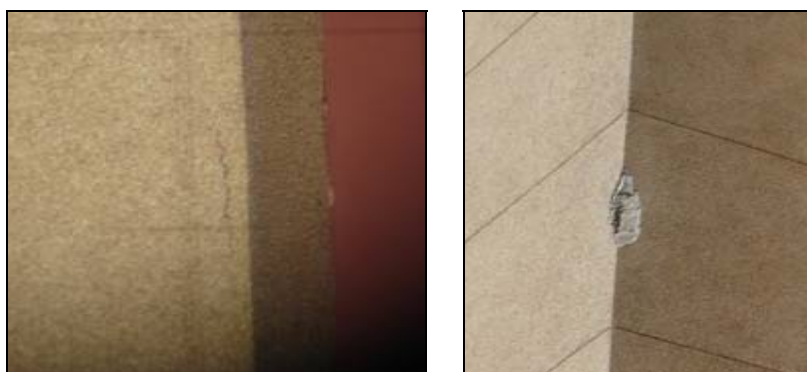
Figura 6 – Fissuras e destacamento no revestimento dos pilares nos níveis superiores (Edifício 1)
