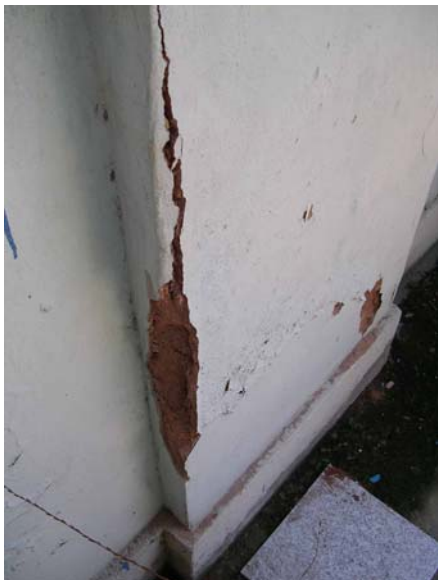
Fig.10 Fissura no reboco. Foto dos autores, 2007
