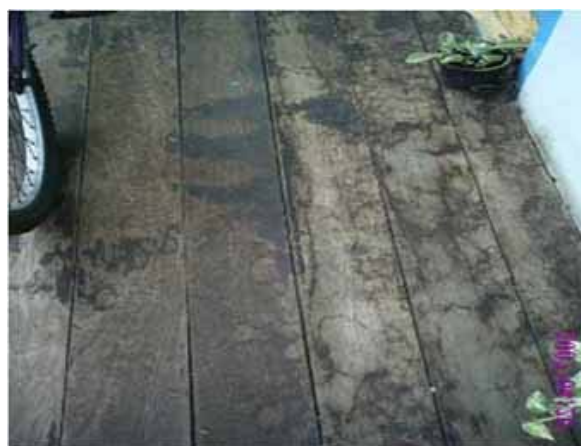
Fig.7 Piso manchado. Foto dos autores, 2007
