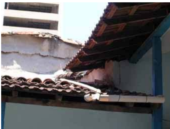
Fig.16 Ausência de calhas. Foto dos autores, 2007
