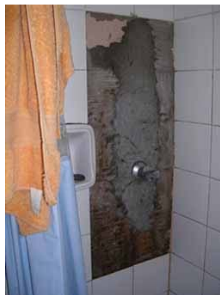
Fig.15 Reparos em alvenarias. Foto dos autores, 2007
