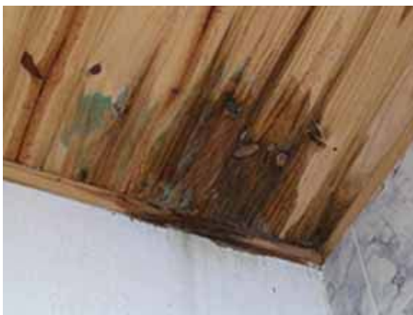
Fig.5 Umidade no forro das unidades do 1º pavimento. Foto dos autores, 2007
