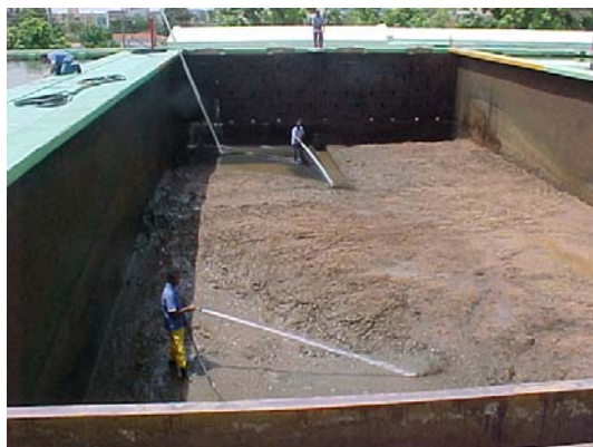
Figura 2 – Procedimento de limpeza dos tanques de decantação e desperdício de água já tratada.
