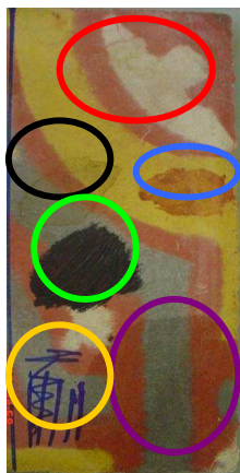
Figura 2 – Ladrilho sem impermeabilização após o manchamento
