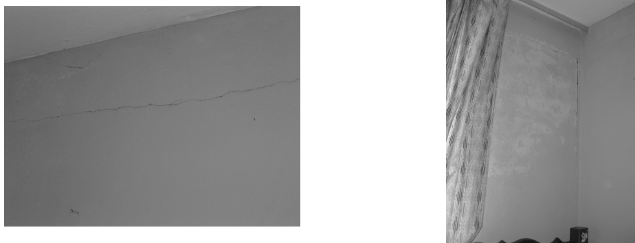
Figura 3 - Trinca entre a estrutura metálica e a alvenaria.
