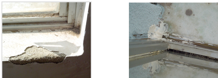
Figura 2- Exemplo do Edifício 4 mostrando a ocorrência de infiltração na interface do fechamento externo e a esquadria e as soluções paliativas dada pelos usuários
