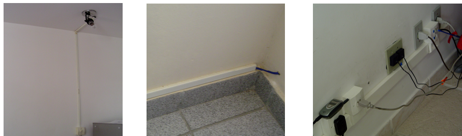
Figura 4 -Exemplos de modificação de instalações elétricas ou de cabeamento, sem usar a facilidade de embutimento destas instalações nos fechamentos internos em gesso acartonado.
