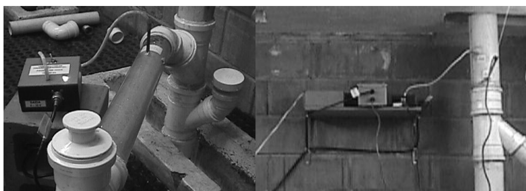
Entrada do tubo de queda
