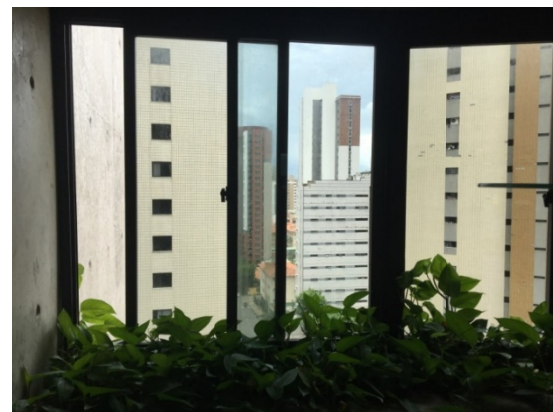
Figura 12 - Fotografia da esquadria instalada nas varandas do edifício Veneza I. Fonte: os autores.
