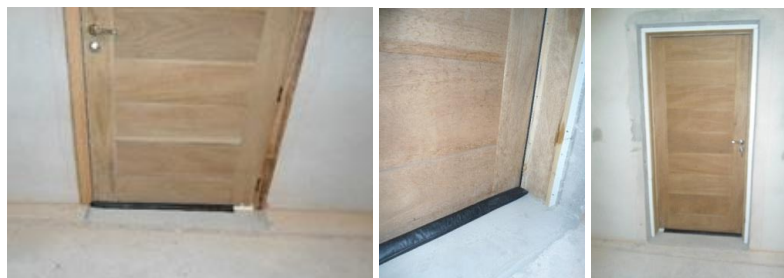
Figura 17 – Porta na situação do Ensaio 21
