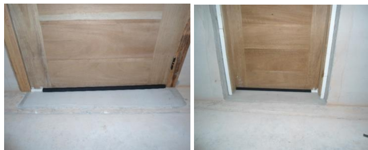
Figura 10 – Porta na situação do Ensaio 14
