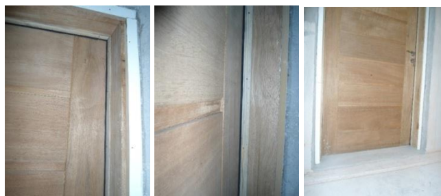
Figura 13 – Porta na situação do Ensaio 17
