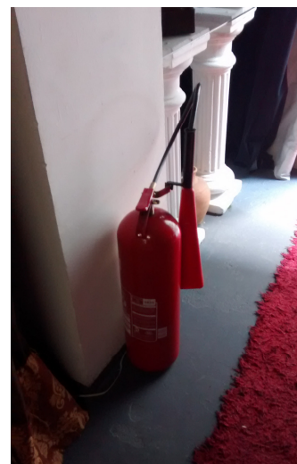
Imagem 5 – Extintor de incêndio.
