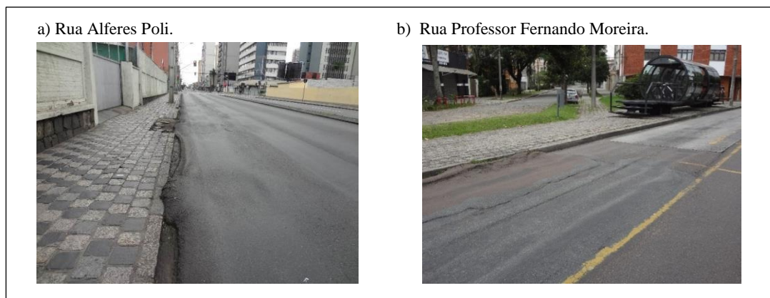
Figura 05 – Exemplos das deformidades do asfalto nos corredores expressos. Fonte: O autor (2014).
