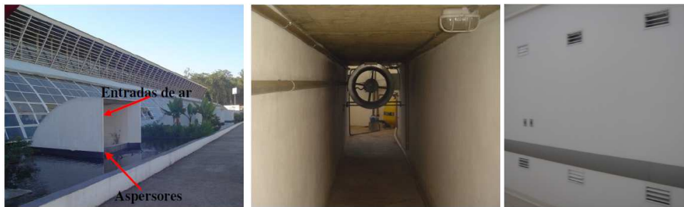
Figuras 2, 3 e 4: ventiladores para captação mecânica do ar externo na entrada das galerias e sistema de insuflamento no interior (Prado et al. 2011).
