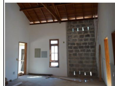
Figura 4 - Foto da recepção (parede trombe) na fase final de obra. Acervo dos autores.
