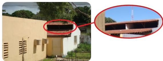
Figura 11 - Detalhe da abertura alta sem fechamento encontrada em dois blocos da Escola Estadual Maria Rosália Ambrózzio.
