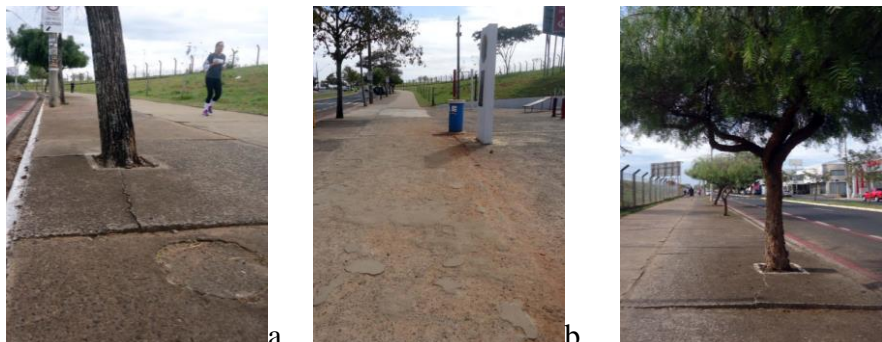
Figuras 8a, b e c - Deformidades no piso.
