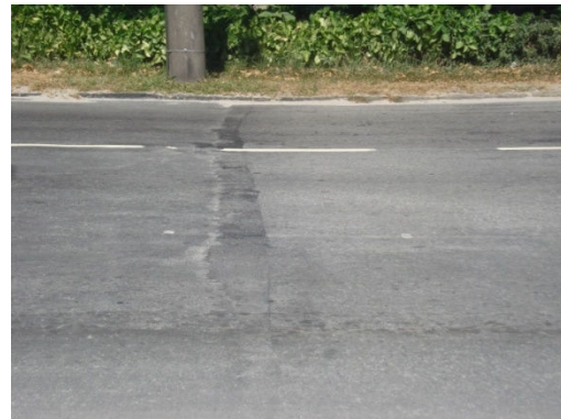
Figura 6 – Vista do pavimento após o recapeamento no trecho de degrau
