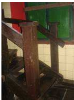
Figura 13 – Ausência de guarda-corpo ao longo da escada (acervo próprio)
