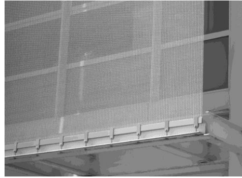
Figura 4: Detalhe do uso externo de tela protetora
