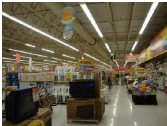
Figura 4 – Luminárias existentes no hipermercado.
