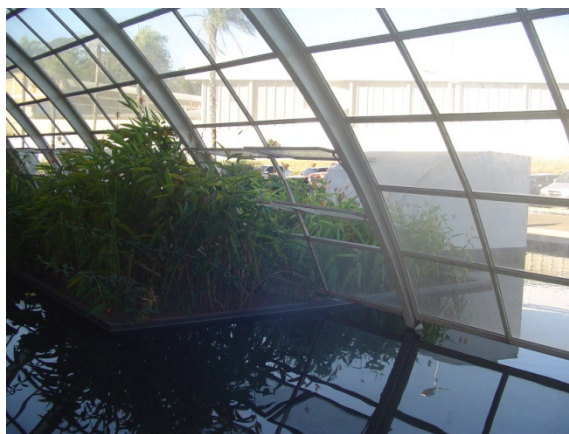
Figura 14: Fachada envidraçada da sala de espera com detalhe da janela basculante e rodapé com abertura fixa
