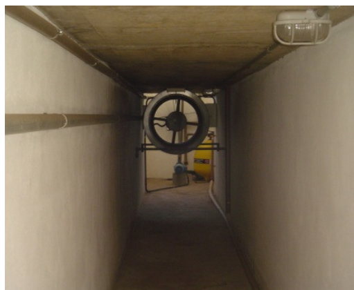
Figura 9 – Ventiladores na entrada das galerias
