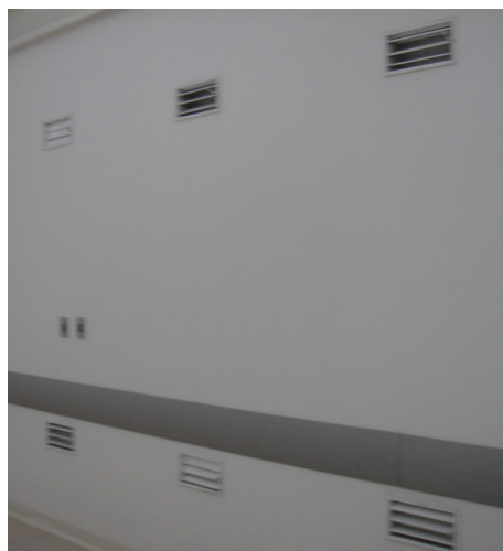
Figura 11 – Venezianas para a saída de ar nos ambientes internos
