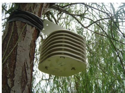
Figura 10 - Exemplo de instalação dos sensores
