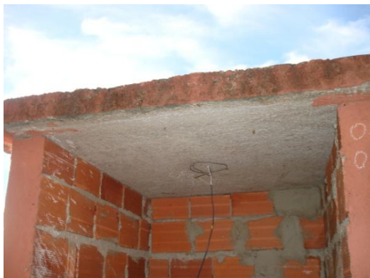
Figura 03 – Termopar para medição da temperatura superficial interna da laje de cobertura
