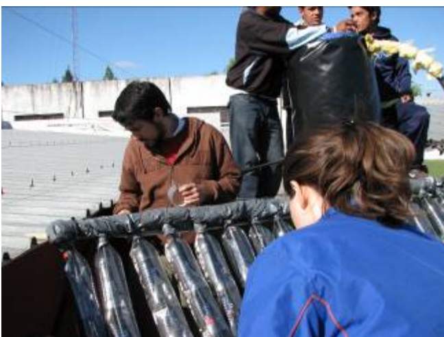
Fig. 4. Etapas de la construcción y puesta en funcionamiento del colector dinámico de botellas.
