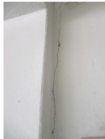
Figura 5 – Fissura na região de contato entre o prédio original e a ampliação
