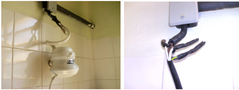
Figura 6 – Instalações elétricas em desacordo com as normas
