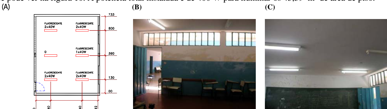
Figura 8 – Sistema de iluminação artificial: (A) Potência instalada; (B) Interferência na iluminação geral; (C) condições de manutenção.
