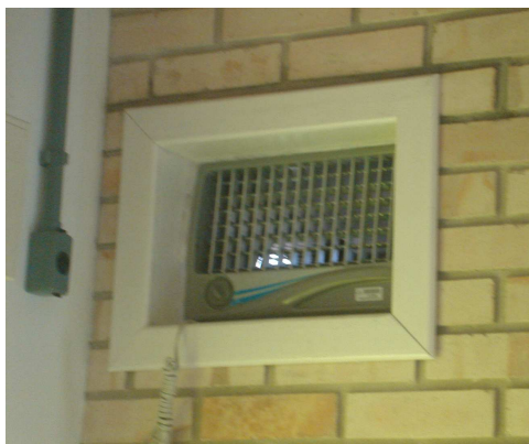
Figura 5 – Insuflador de ar posicionado no quarto de casal.
