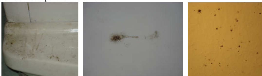
Figura 3 - Colônias de fungos nas superfícies.
