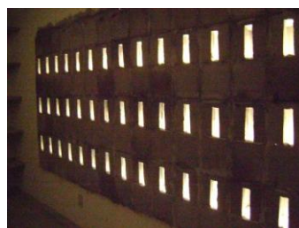
Figura 24. Foto do bloco caixa aberto (vista interna)
