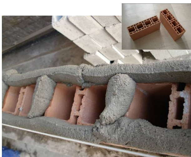
Figura 6: Construção de parede de bloco cerâmico, no Brasil, com o uso de bisnaga. No detalhe, peças de bloco cerâmico.
