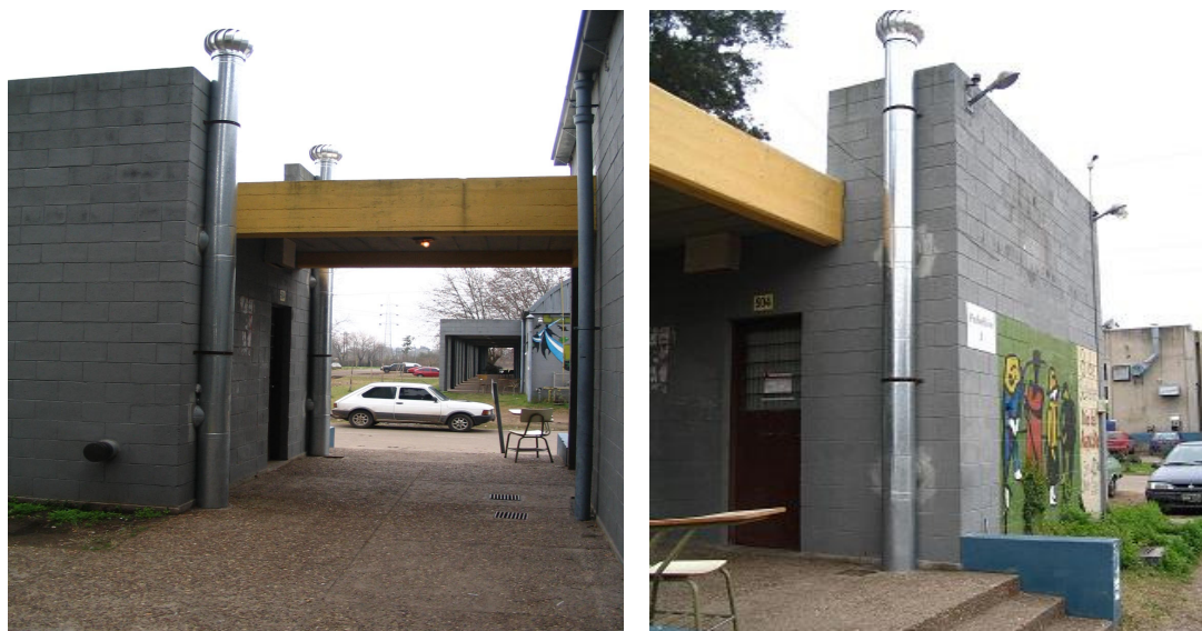
Fig. 3 y 4 – Aspiradores eólicos instalados al tope de conductos exteriores en la cara SE
