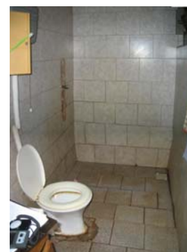
Figura 03: Banheiro da UH NE H2-8, escuro.
