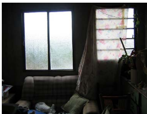
Figura 02: Sala da UH NE H1-10, com iluminação excessiva.
