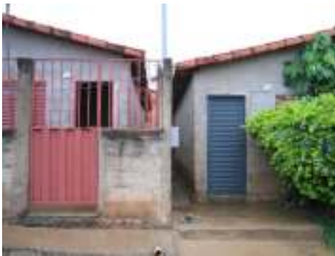
Fig. 2 – Implantação de casas próximas uma às outras em Paracatu, gerando patologias como mofo por falta de aeração e insolação.
