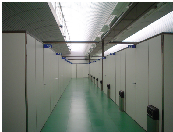
Figura 5 - Vista dos difusores de ar no ambulatório (passagem do ar das galerias para os ambientes).
