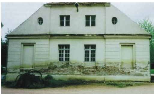
Figura 2 - Danos causados por umidade em edificações de interesse histórico (fonte: HENRIQUES, 1995)
