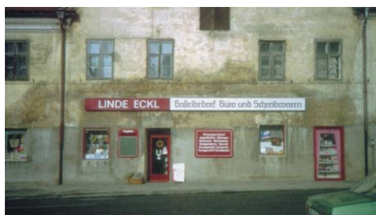
Figura 3 - Danos causados por umidade em edificações de interesse histórico (fonte: HENRIQUES, 1995)
