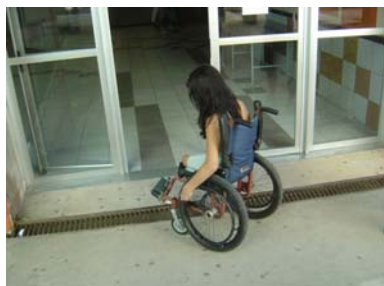
Imagem 01 - Desnível no bloco D
